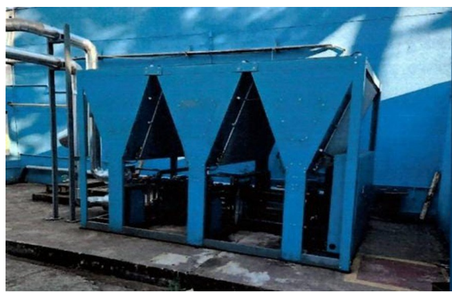
Chiller Hospital Pimentas Bonsucesso
